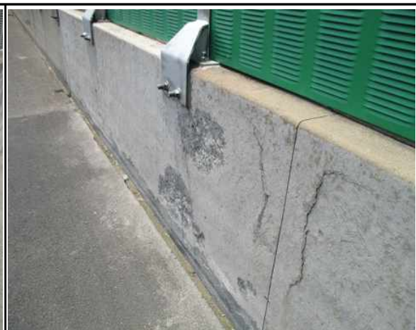
하행선 S20 콘크리트 박락 및 균열
