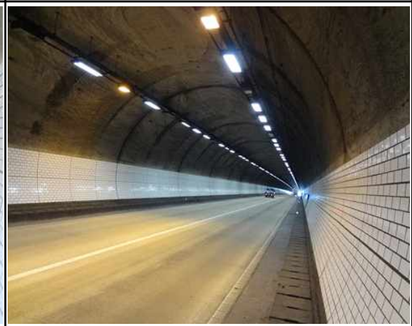
하행선 조명시설 전경
