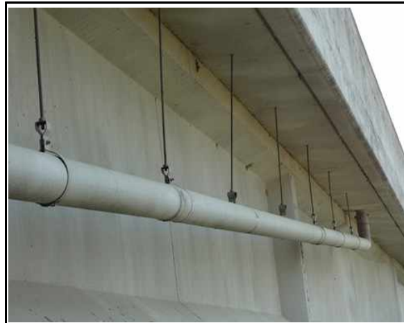
상행선 S1 배수관 연결고리 탈락
