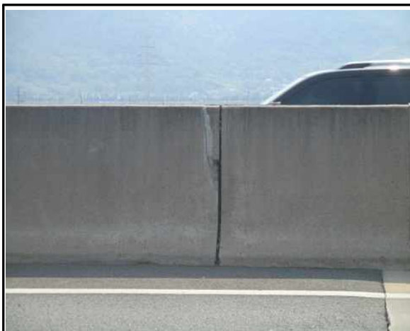
하행선 S1 중앙분리대 균열
