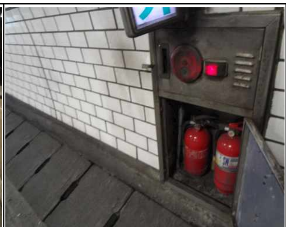
하행선 소화기 전경
