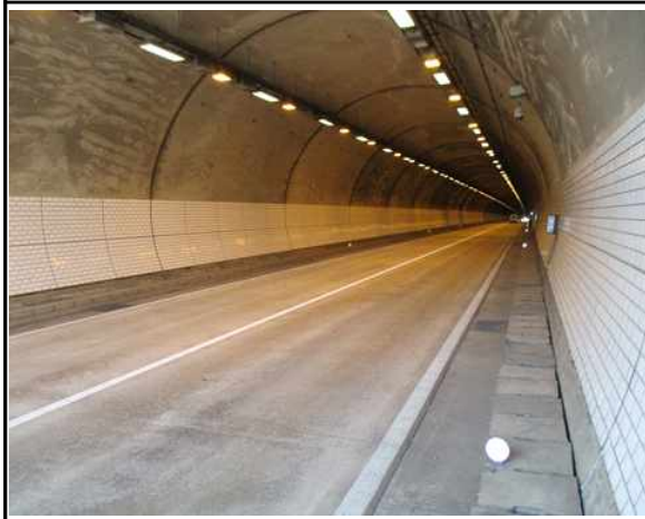
상행선 조명시설 전경
