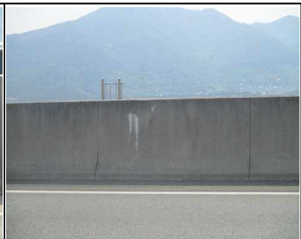
하행선 S2 중앙분리대 백태
