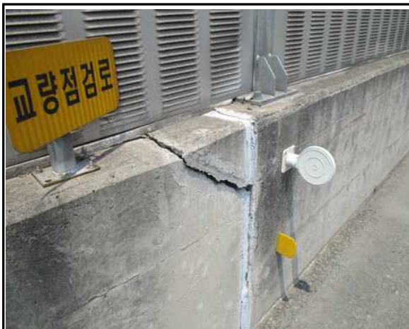
하행선 S1 콘크리트 파손
